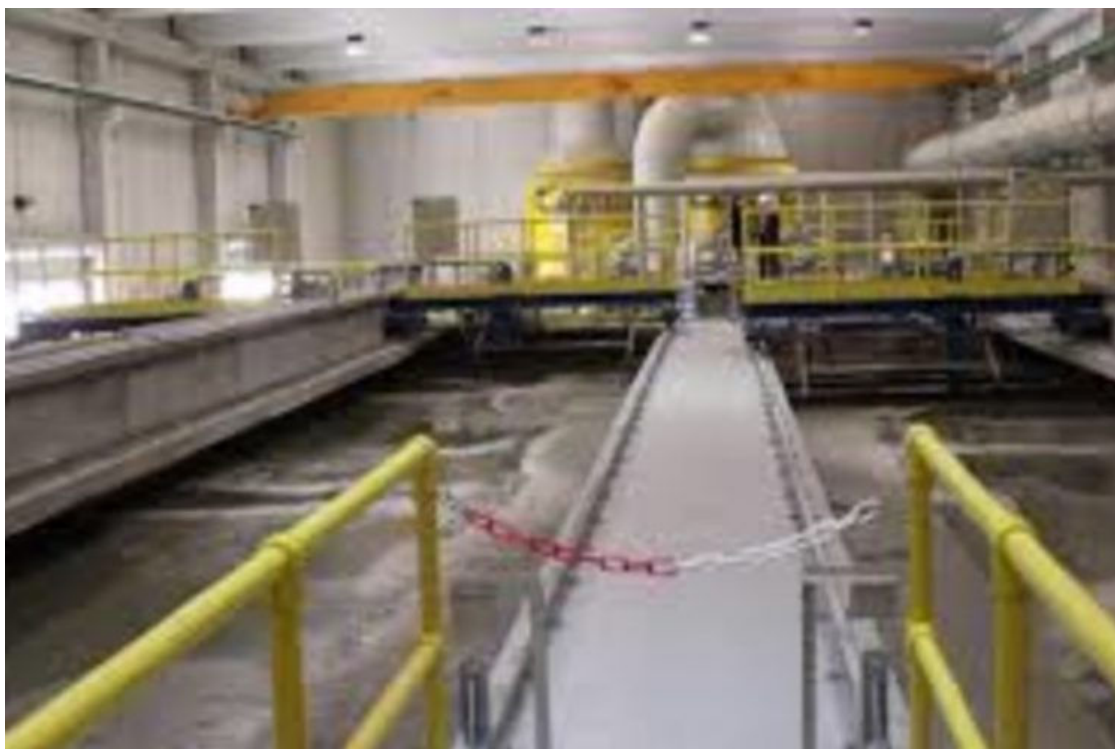
Estación Depuradora de Algeciras. Archivo
