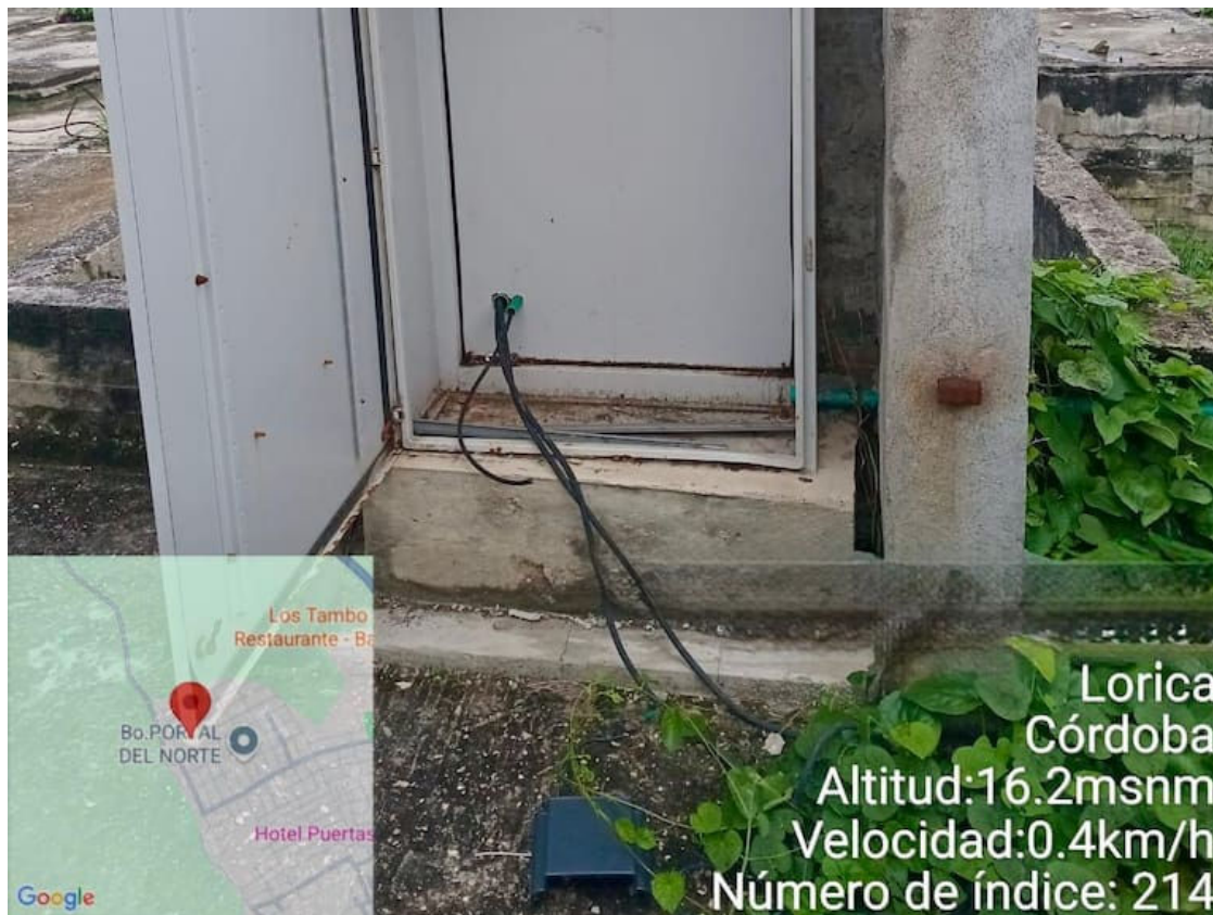
Fue vandalizada la Estación de Bombeo de Aguas Residuales (EBAR) La Victoria en Lorica, Córdoba.
