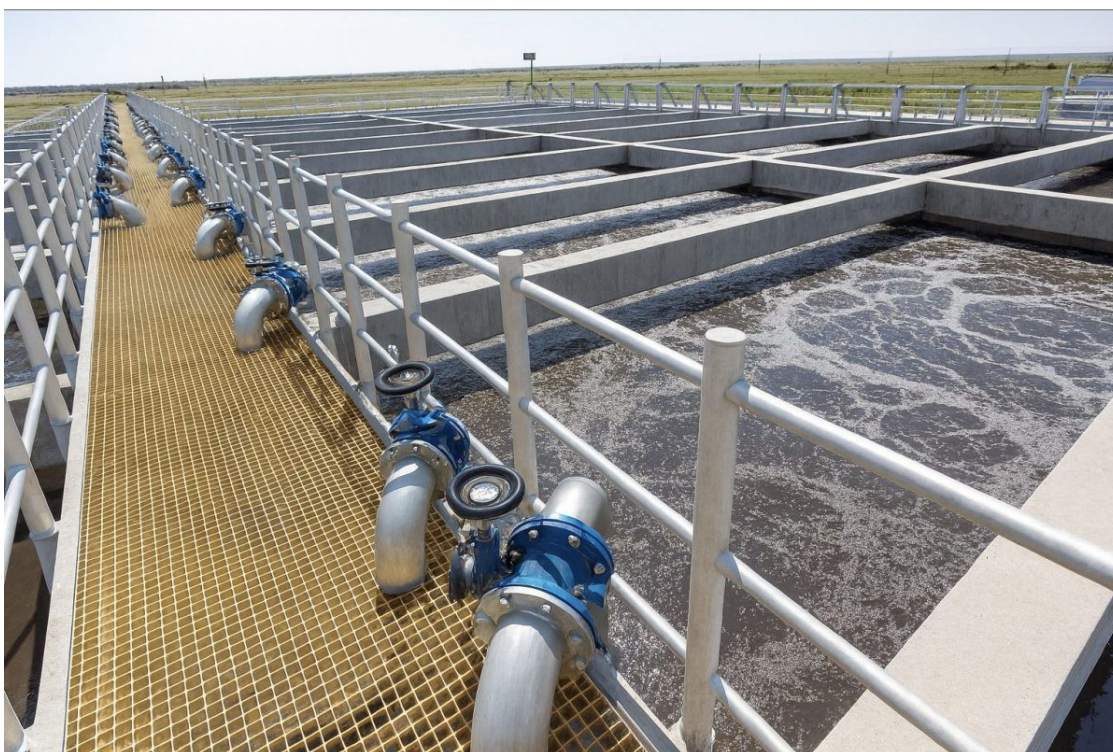
Instalaciones de tratamiento de aguas
